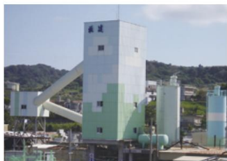
バッチャープラント
