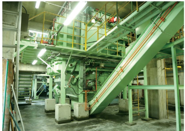
ごみ焼却炉 設備
