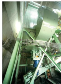
ごみ焼却炉 設備
