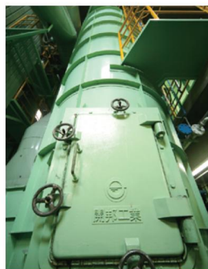
ごみ焼却炉 設備
