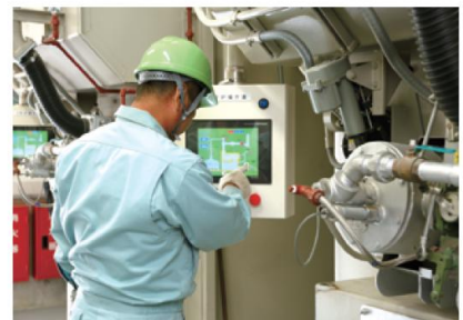
火葬炉 作業風景
