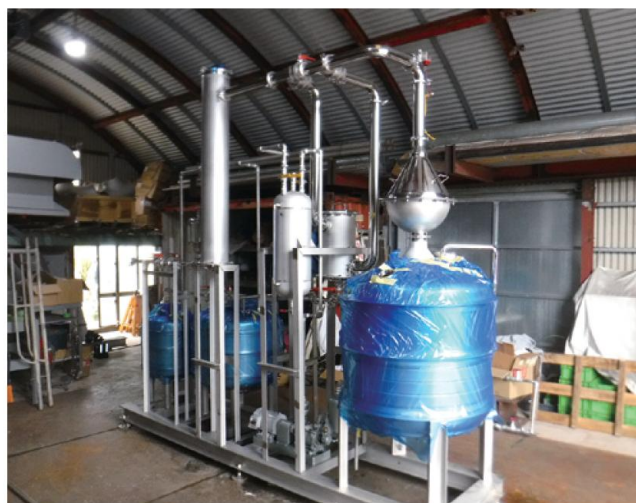
300L泡盛製造蒸留機
