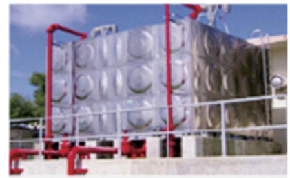
パネルタンク
