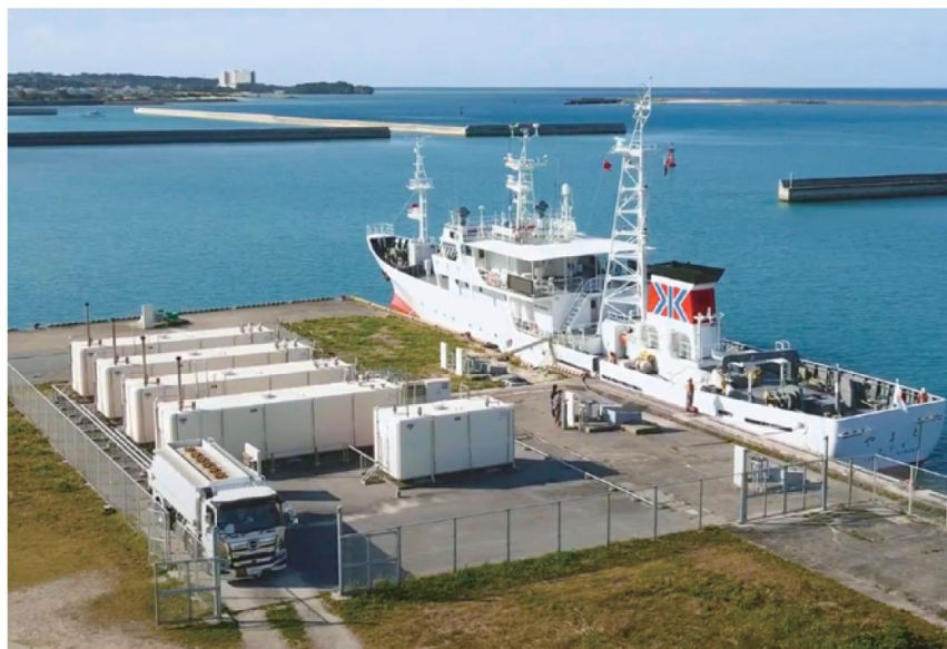
コンボルト型タンクを使用した船舶給油取扱所
