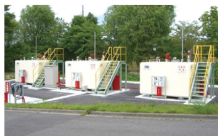
コンボルト型タンクの外観
