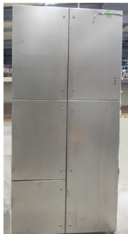
ステンレス製制御盤
